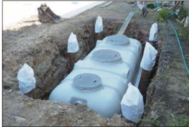
M邸雨水タンク (5.6t貯留)
